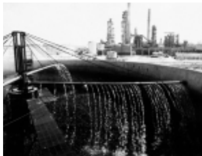
▲ Équipements d'épuration par voie biologique dans une raffinerie
