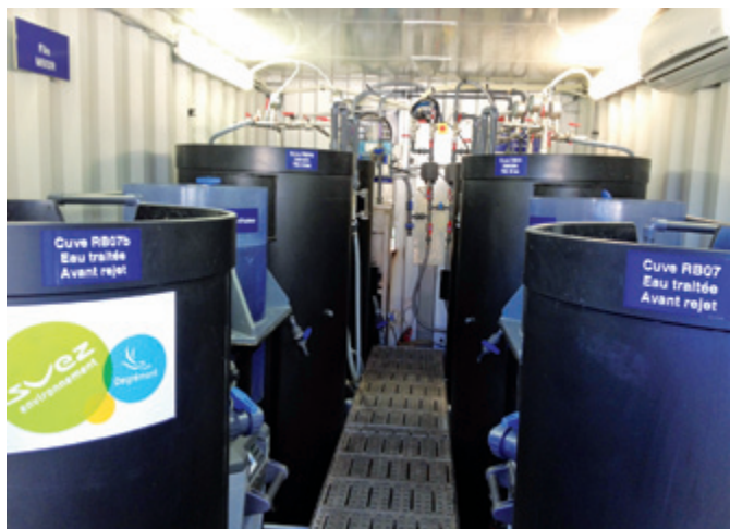
Tests de traitement avancé de l'Université de Limoges sur le site de SIPIBEL (F)
